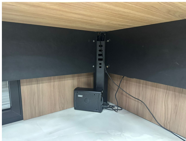
Imagem interna da mesa, demonstrando haver a necessidade de uma calha/duto vertical, em uma das bases, para passagem de fios.
